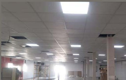
Plafond démontable 60*60 chez SAGEM
